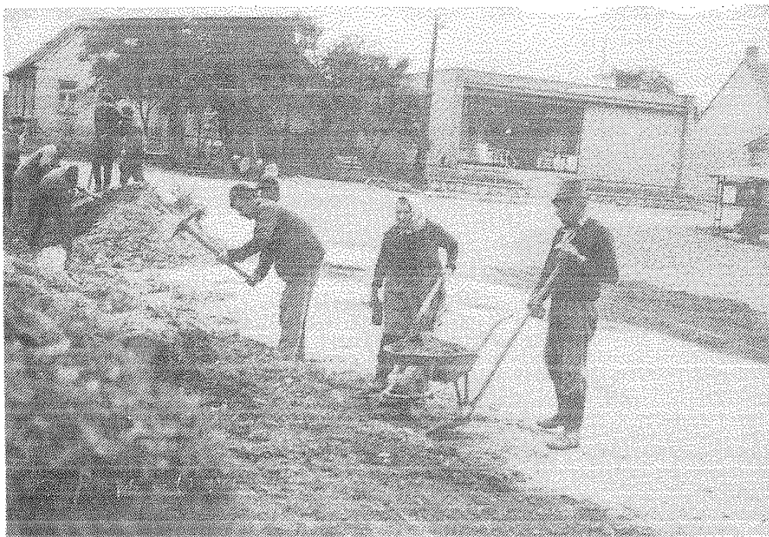
Obr. 4. Budování obecní kanalizace (foto brigádníků — záběr od křížku před budovou OÚ, v pozadí prodejna)
